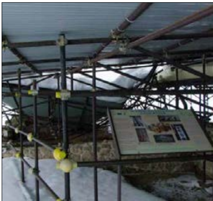
Il crollo di una parte della tettoia dell'area archeologica di San Vincenzo
